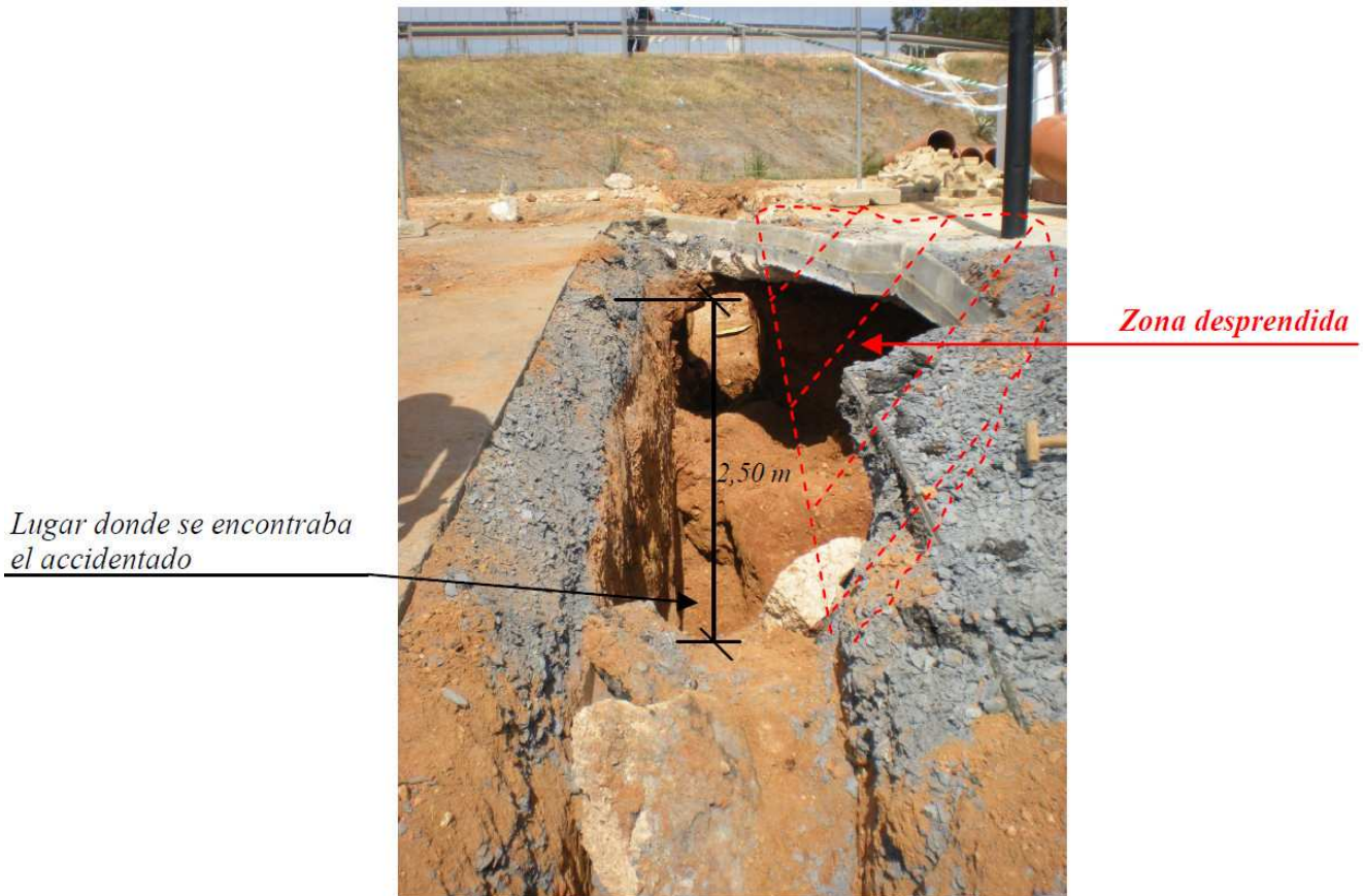
Imagen 2. Vista opuesta a la imagen 1. Lugar del accidente desde la zona por donde bajó el trabajador accidentado.
