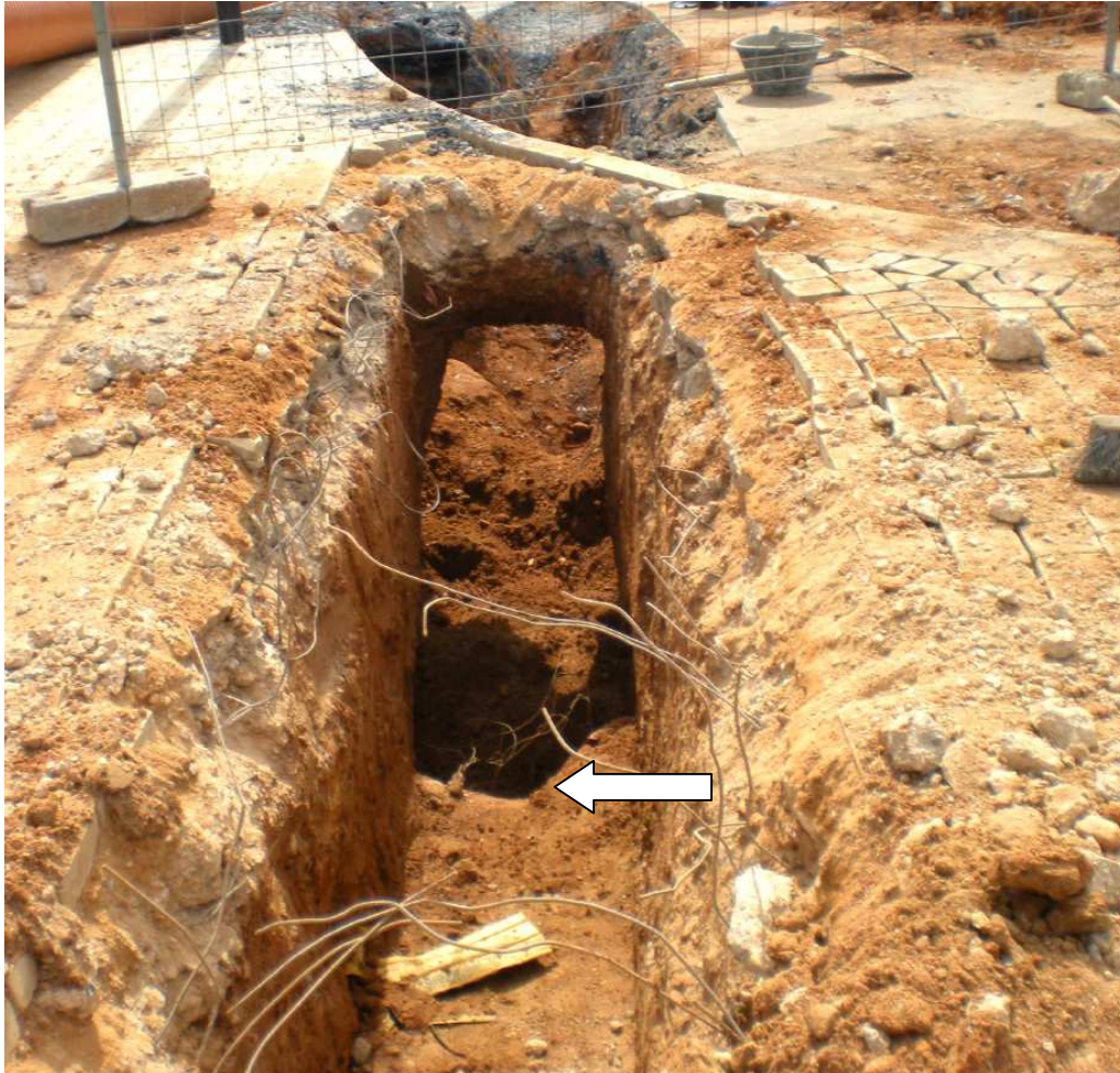
Imagen 1. Vista del lugar del accidente desde donde estaba la retroexcavadora. En la zona más próxima y hasta la línea eléctrica subterránea (señalada con flecha) la profundidad de la zanja era 1,35 m y a partir de ahí de 2,5 m.
