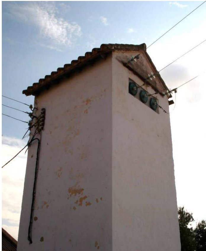
Imagen 1. Centro de transformación en caseta de obra que tenía que pintarse
