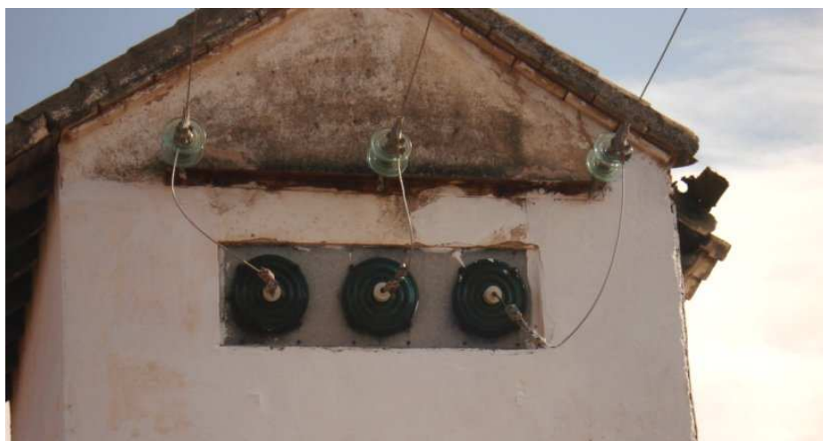
Imagen 4. Se aprecia la zona recién pintada donde introdujo la brocha para pintar produciéndose el contacto eléctrico directo.
