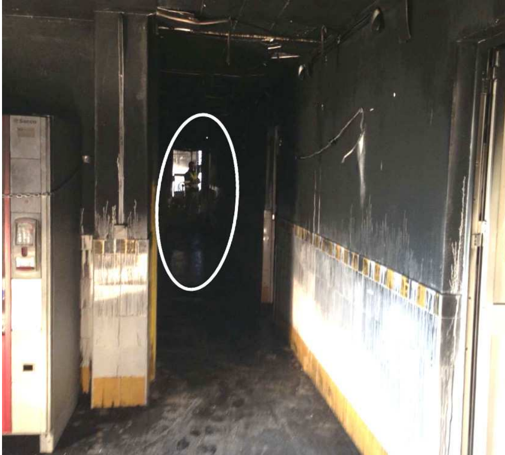
Imagen 2. Estado en el que quedaron las instalaciones. Al fondo, en blanco, entrada a habitación incendiada.
